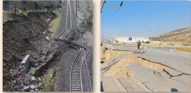
Εικόνα 6: Επιφανειακές διαρρήξεις, ρωγμές και ζημιές σε σιδηροδρομικές γραμμές και δρόμους στο νότιο τμήμα της πόλης Kahramanmaraş. (Cetin et al., 2023)
