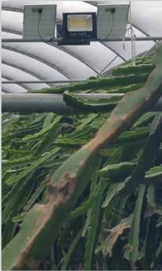
Λάμπες φωτός παραπλήσιου στο ηλιακό φως για επέκταση της παραγωγικής περιόδου των φυτών dragon fruit μέχρι και τη χειμερινή περίοδο.
