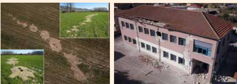
Σχήμα 5: Ρευστοποιήσεις στην επικεντρική περιοχή λόγω του σεισμού της 3ης Μαρτίου 2021 (αριστερά) και το Δημοτικό Σχολείο στο Δαμάσι, ένα κτήριο ηλικίας 80 χρόνων, το οποίο καταστράφηκε ολοσχερώς από τον σεισμό (δεξιά) και στη συνέχεια κατεδαφίστηκε για λόγους ασφαλείας (Newsletter of Environmental, Disaster and Crises Management Strategies, 22, ISSN 2653-9454).
