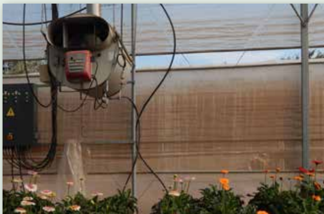
Αερόθερμα σε θερμοκήπιο
