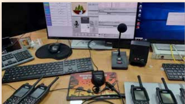
Ανάπτυξη και βελτίωση του υφιστάμενου συστήματος τηλεπικοινωνιών
